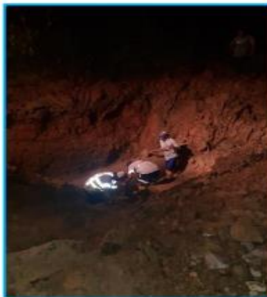
Descubrimiento manual del tubo de asbesto cemento de 800mm en el punto de la fuga.
