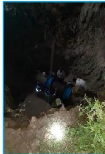
Ajuste de pernos de acero inoxidable en cada una de las uniones mecánicas asimétricas.
