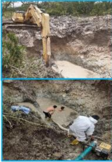
Excavación para descubrir el tubo de asbesto cemento de 700mm averiado; y bombeo para desaguar el punto de fuga
