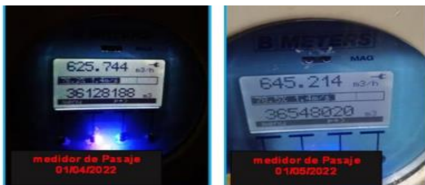
Ejemplo: Lecturas del Medidor de Caudal de Pasaje (Abril/2022)
